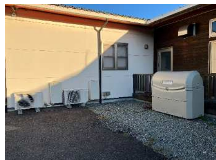
図 3-10 パワコン・蓄電池設置想定箇所
