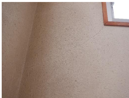
【劣化状況】 ひび割れ被害
