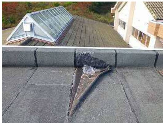
防水シート剥がれ（校舎の屋上）
