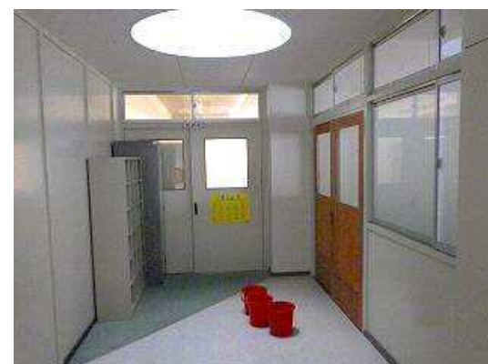
雨漏り対策（校舎2階 バケツの設置）
