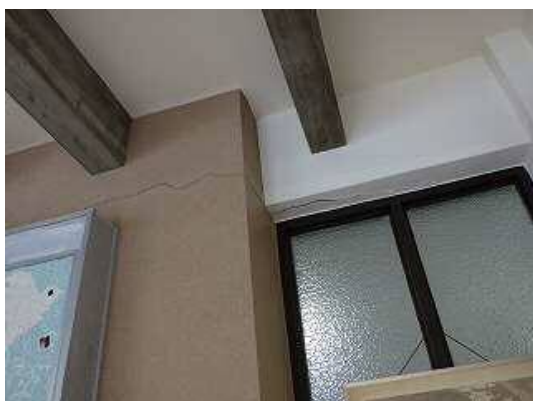
ひび割れ（校舎玄関部分）
