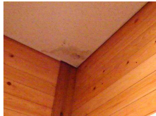
雨漏り痕（体育館）
