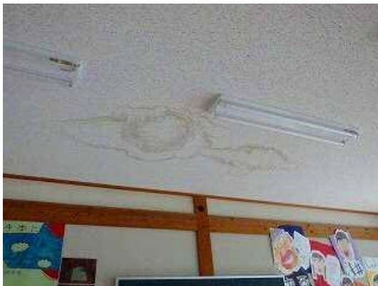
雨漏り痕（校舎（図書室））
