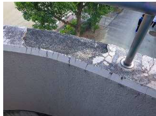
手すりモルタル剥がれ（体育館 2 階）
