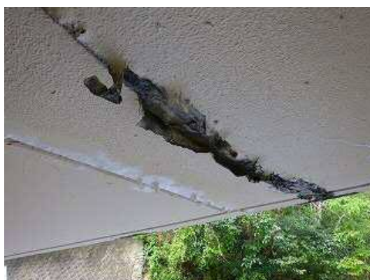
ひび割れ（体育館）
