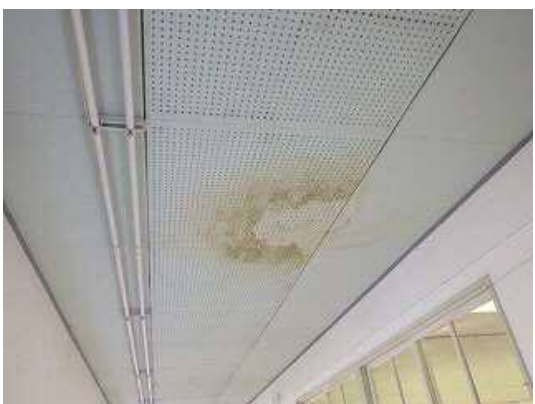
雨漏り痕（校舎3階）
