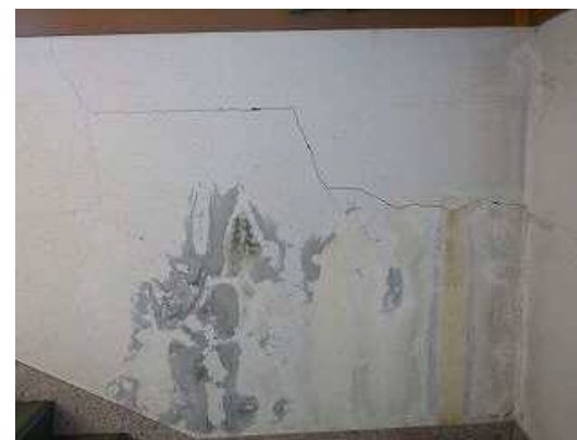
ひび割れ、塗装の剥がれ（体育館階段部分）
