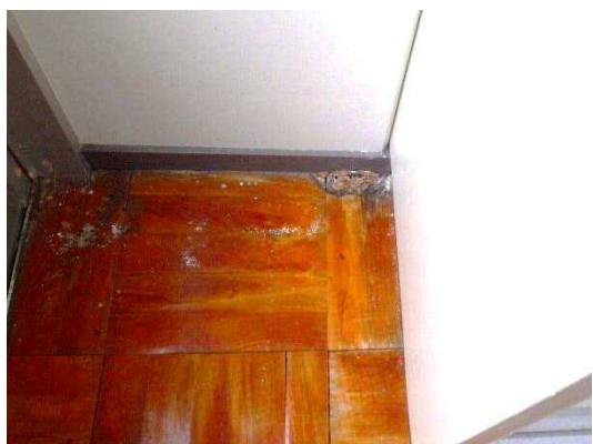
床の腐食（特別教室棟）
