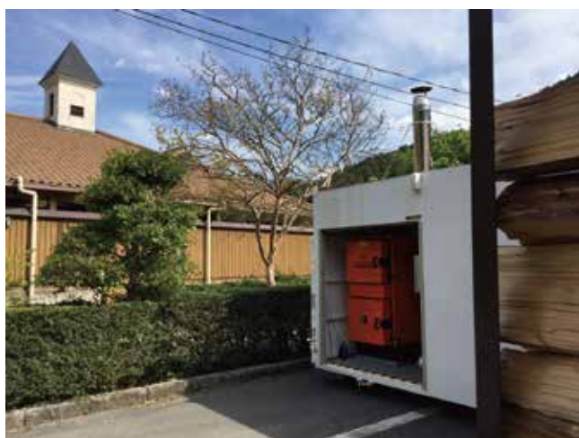
奥伊勢フォレストピアにおいて、豊かな森林資源を温泉熱源として活用する木質バイオマス設備を導入
